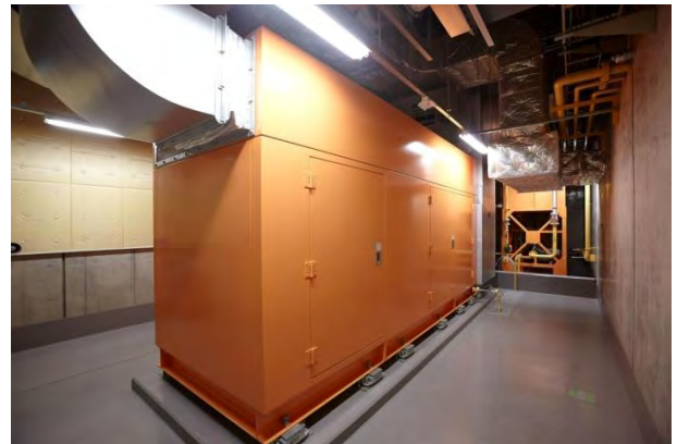
非常用発電機
